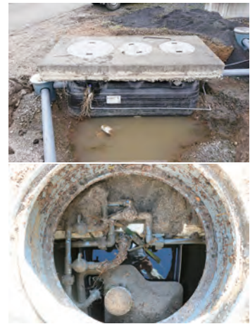
洗掘された浄化槽(上)と土砂が流入した浄化槽
