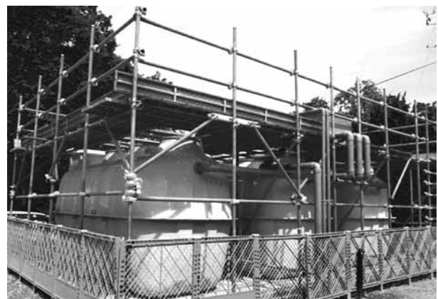
地上設置型の仮設住宅浄化槽
