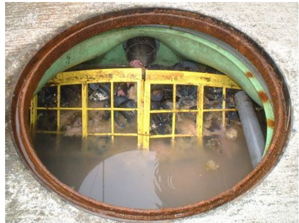
【写真－２】ろ材の浮上
