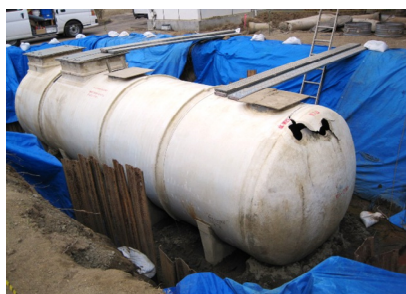
写真-9 接続部の破損
