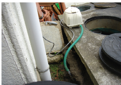
写真-13 応急対応(送気管破損)
