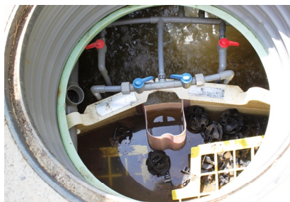
写真-7 仕切板の破損
