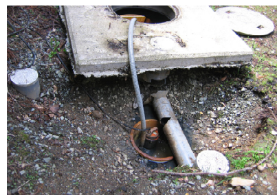
写真-14 応急対応(流入管破損)
