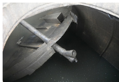
写真-8 スロッシングの影響
