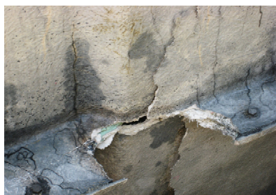
写真-2 フランジ部の破損
