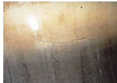
写真-3 亀裂の状況
