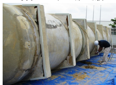
写真-5 支持脚部の破損
