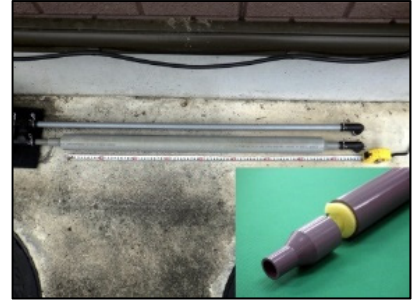
写真-3 サイレンサー
